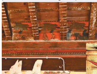
Plafond peint avec traces d'arrachements du faux-plafond
